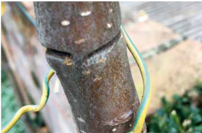
Solche Einschnürungen sind nach Möglichkeit zu vermeiden. Jetzt ist eine gute Zeit, um die Verbindungen zu kontrollieren. Foto: Krüger
